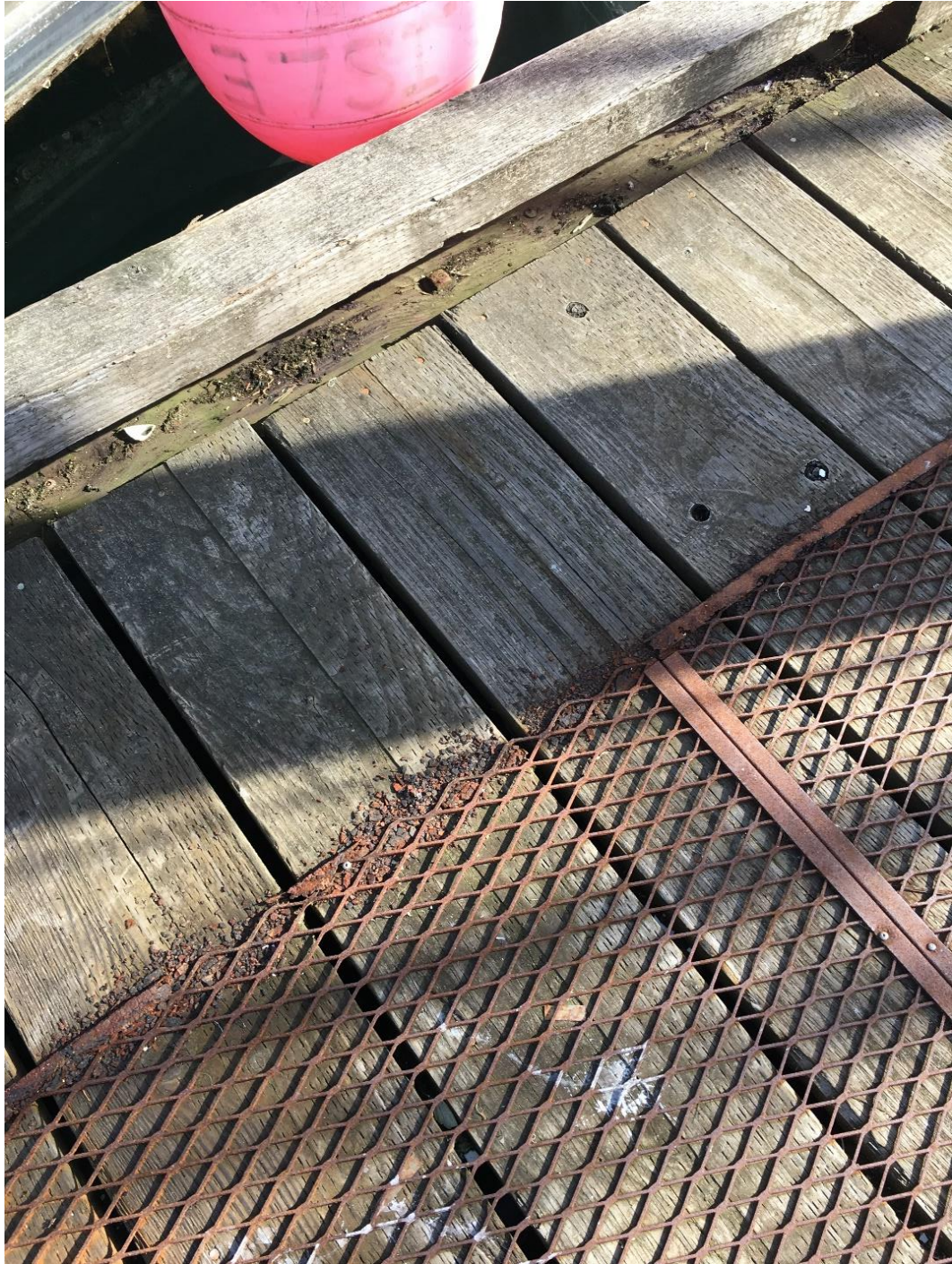
Figure 1 — Treillis métalliques rouillés récemment installés à Bella Bella, en Colombie-Britannique
